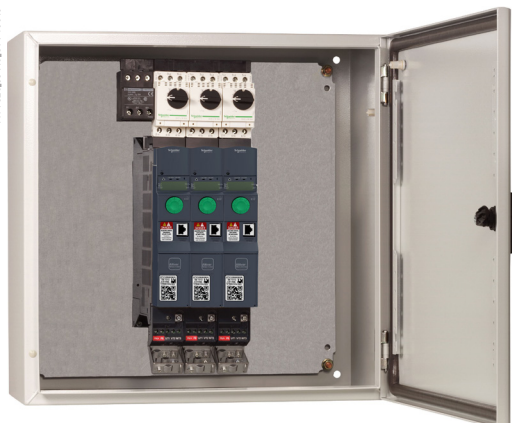
制御ボックス内 GV2/ATV320 直付けの例:GV2L 回路遮断器 + GV2454 および GV2G05 アクセサリ + ATV320U15N4B ドライブ
